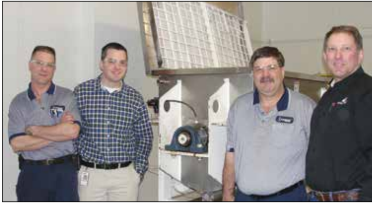
Matt Nicol (rechts), regionaler Leiter bei Inpro/Seal, und Neogen-Mitarbeiter stehen vor einem der Schneckenmischer mit dem neu installierten Inpro/Seal® Air Mizer®.
