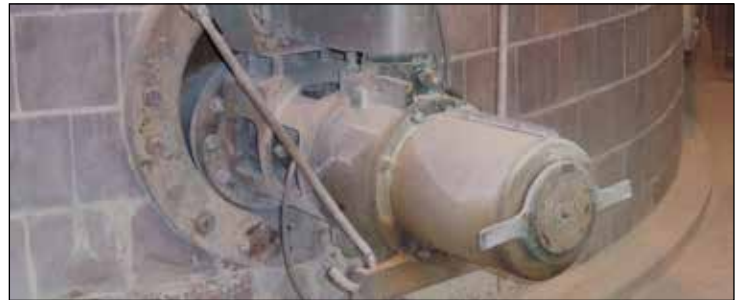
Eines der vier Schlammrührwerke, auf denen Inpro/Seal Air Mizers (Sperrluftdichtungen) installiert wurden, um Produktverlust zu eliminieren und die Wartungskosten zu senken.
