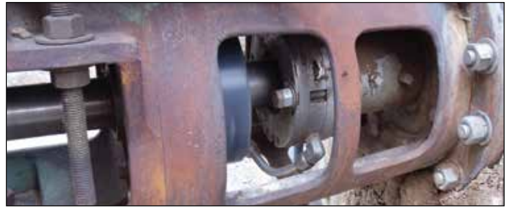
Einer der zwei Air Mizer aus Edelstahl in geteilter Ausführung, die auf Weißlaugentank-Rührwerken installiert wurden.
