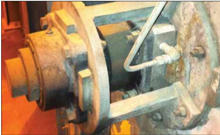
Eine Air Mizer-Dichtung verhindert das Austreten von Aschenschlamm aus einem Aschenförderer eines kohlegefeuerten Dampfkessels.
